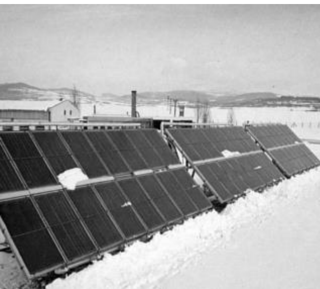
JRD Pliešovce, pôvodná inštalácia z roku 1986
